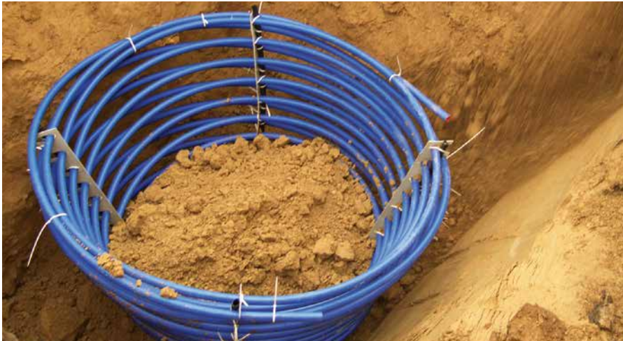
Erdwärmekörbe fördern die Wärme der oberen Erdschicht.
